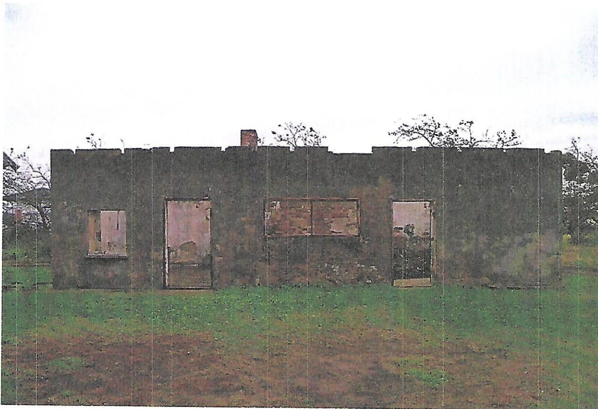
Zdj.8 Ruiny budynku gospodarczego nr 2, widok od frontu
