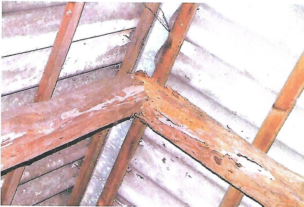
Zdj. 3 Krokiew ze śladami korozji biologicznej
