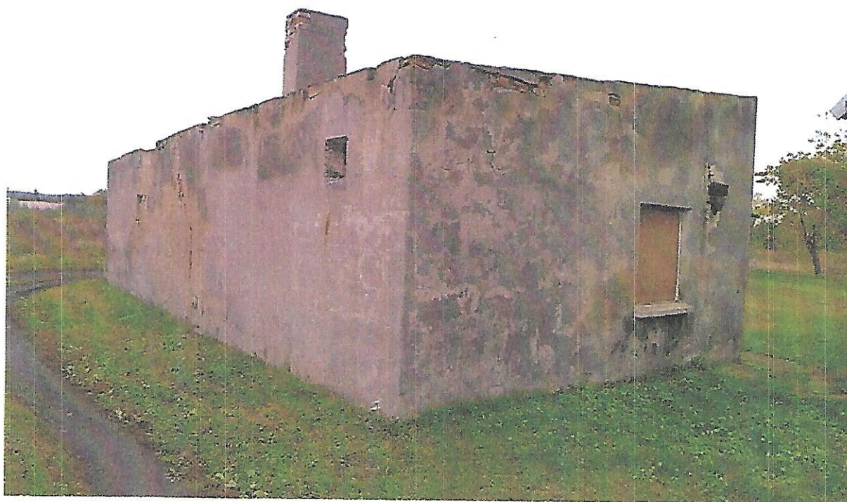
Zdj.9 Ruiny budynku gospodarczego nr 2, widok od tyłu.
